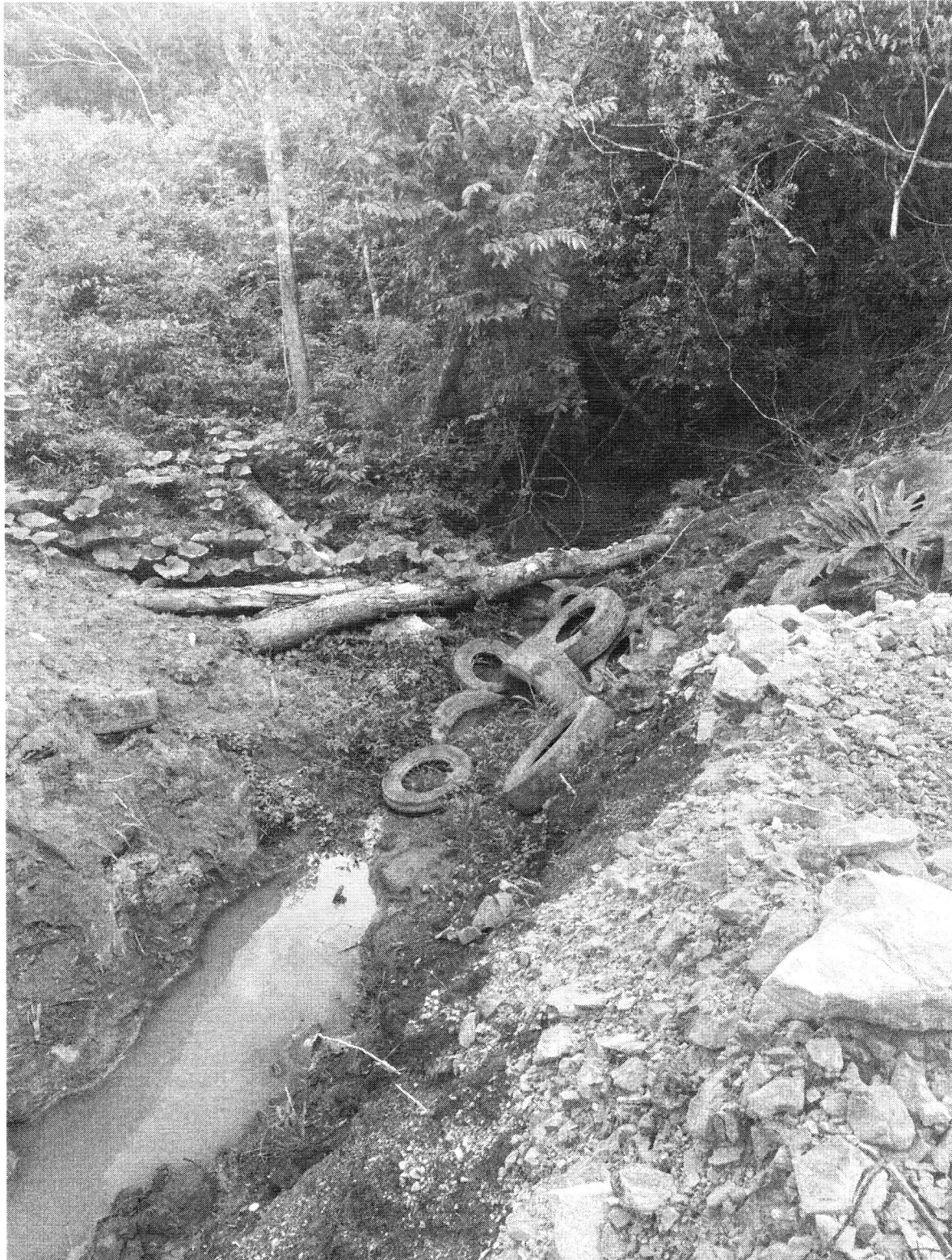
Foto 5 – Taponamiento de curso de agua afectado por construcción de la futura cantera en violación de la Ley 3239/07 “De los Recursos Hídricos del Paraguay”.
