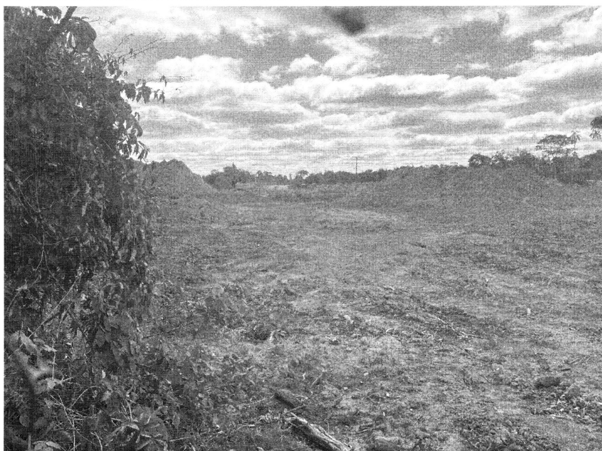
Foto 12 y 13 – Taponamiento, desvío de curso de agua y relleno de humedales, en violación de la Ley 3239/07 “De los Recursos Hídricos del Paraguay”.
