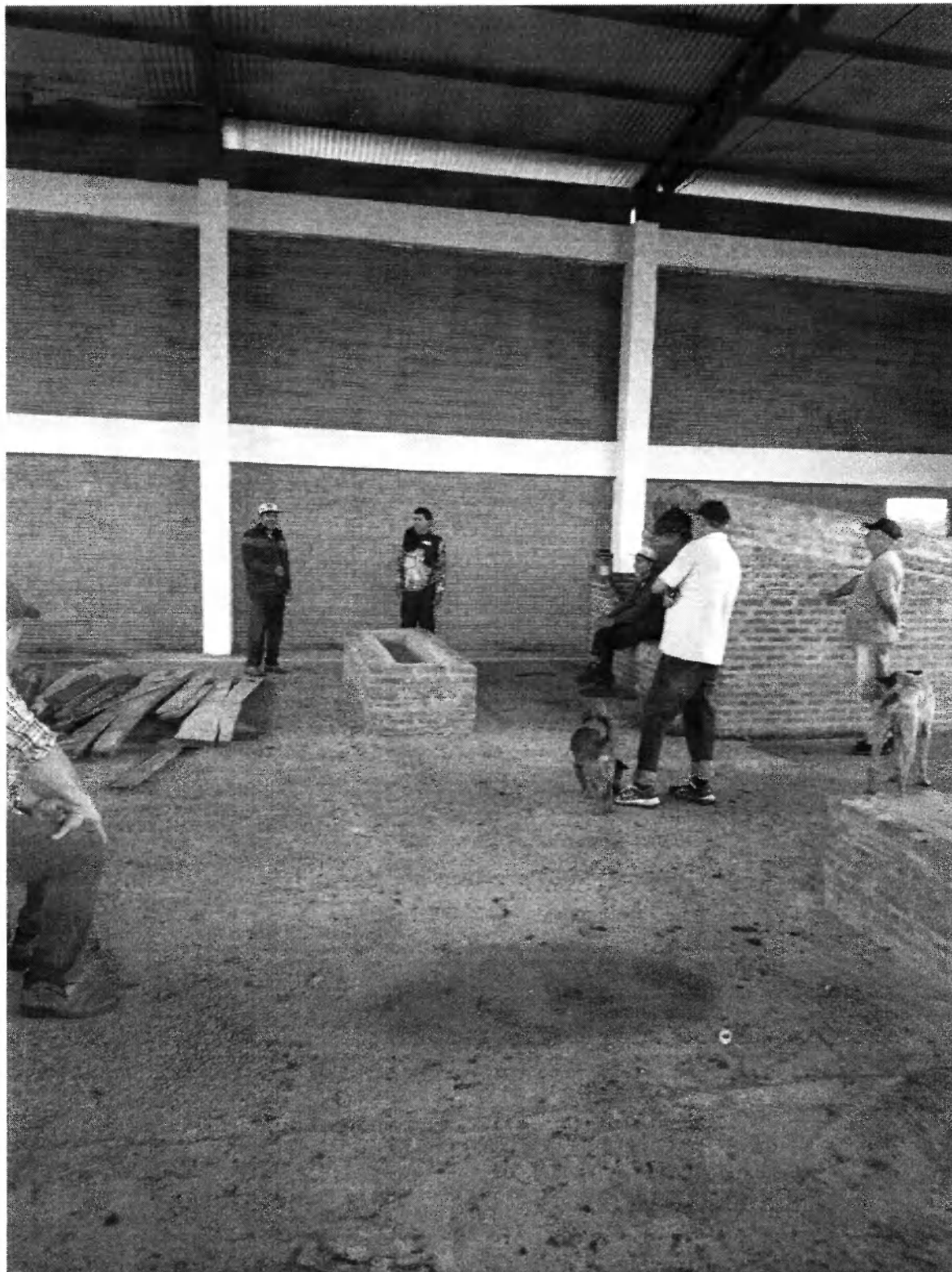
El Técnico del MAG (izquierda) explicando las falencias de la construcción de la base del secadero.
